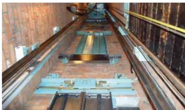
Монтаж лифтового оборудования, кронштейнов направляющих и механизмов порталов к стенам лифтовых шахт, выполненных из кладочных материалов и пустотелого кирпича
